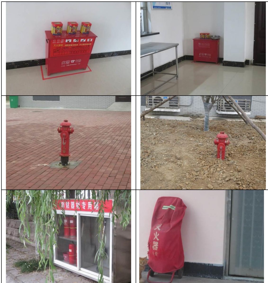
图 10.2-3 灭火器及消防栓
